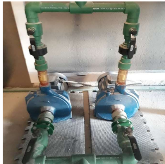
BOMBA DE IMPULSIÓN
