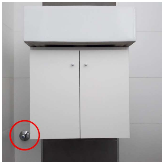
LLAVE DE PASO EN BAÑOS
