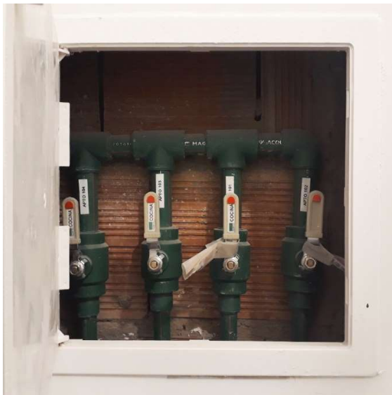
LLAVES DE PASO EN PALLIER
