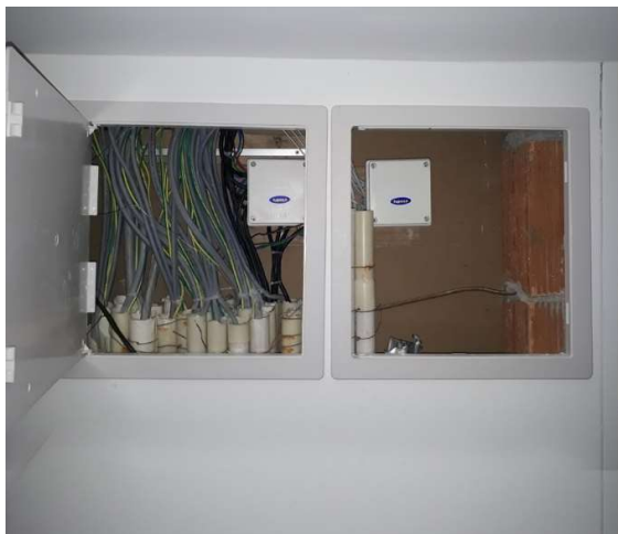
MONTANTE ELÉCTRICA EN PASILLOS
