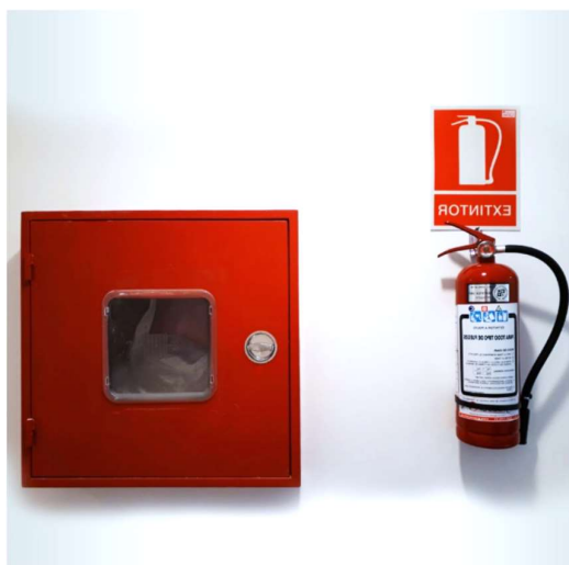
NICHO EN PASILLOS DE TODOS LOS NIVELES
