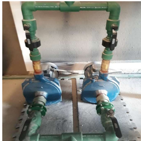
BOMBA DE IMPULSIÓN
