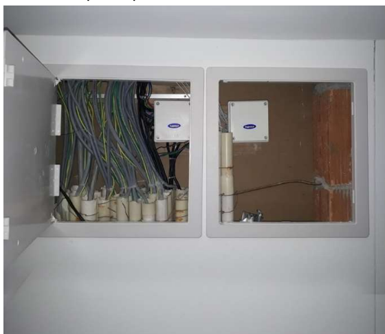
MONTANTE ELÉCTRICA EN PASILLOS
