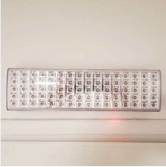
LUMINARIA DE EMRGENCIA EN ESCALERAS
