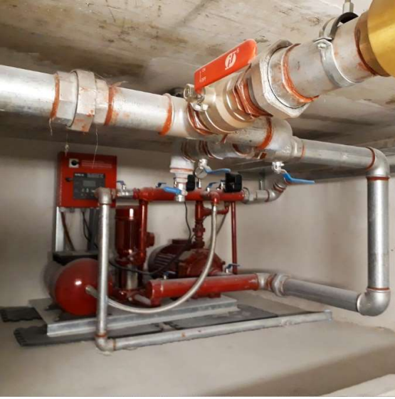
BOMBA DE INCENCIO PISO 9
