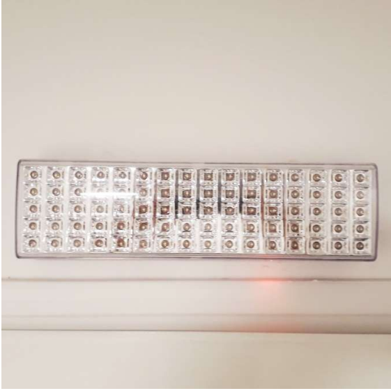
LUMINARIA DE EMRGENCIA EN ESCALERAS
