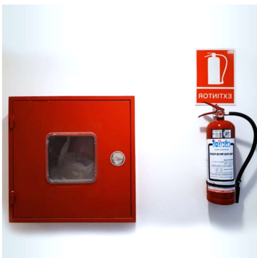
NICHO EN PASILLOS DE TODOS LOS NIVELES
