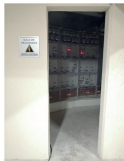
SALA DE CONTADORES SUBSUELO
