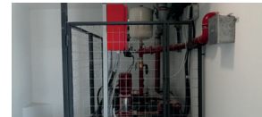
BOMBA DE INCENDIO NIVEL 11
