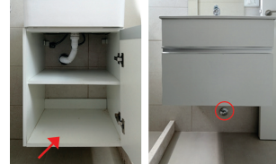
LLAVES DE PASO EN BAÑOS
