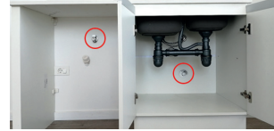
LLAVES DE PASO DE LAVARROPAS Y ABASTECIMIENTO COCINA
