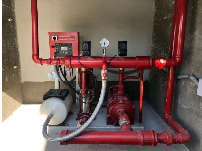
SALA DE BOMBAS DE INCENDIO
