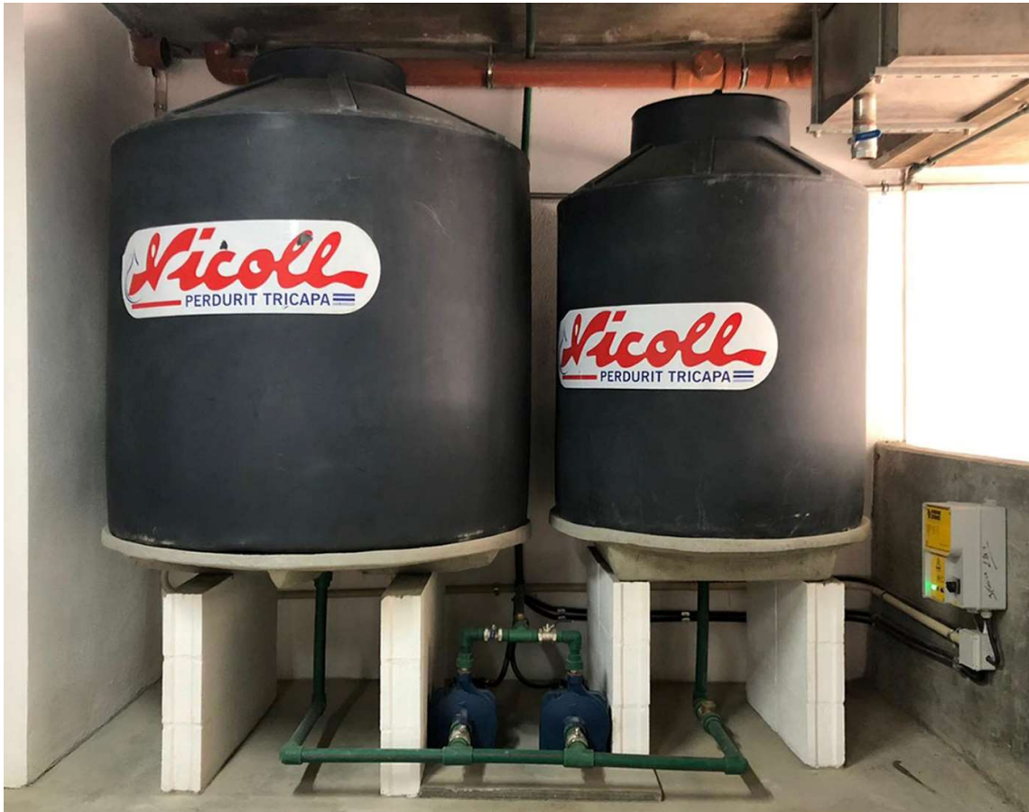
TANQUES INFERIORES - BOMBA DE IMPULSION - COMANDO
