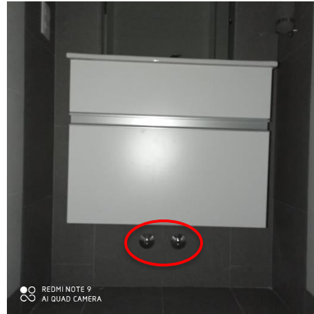
LLAVES DE PASO EN BAÑOS
