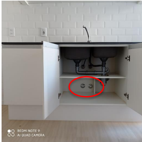
LLAVE DE PASO ABASTECIMIENTO COCINA
