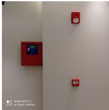
CENTRAL DE ALARMA PLANTA BAJA
