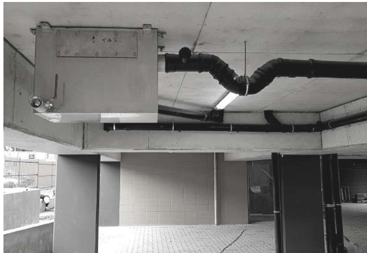
GRASERA COLECTIVA SUSPENDIDA (UBICACIÓN PLANTA BAJA)
