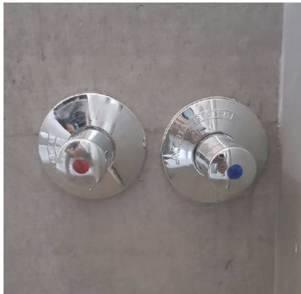
LLPP BAÑOS (UBICADAS DEBAJO DEL MUEBLE) - ABASTECIMIENTO AGUA FRÍA + AGUA CALIENTE (DE CALEFÓN)
